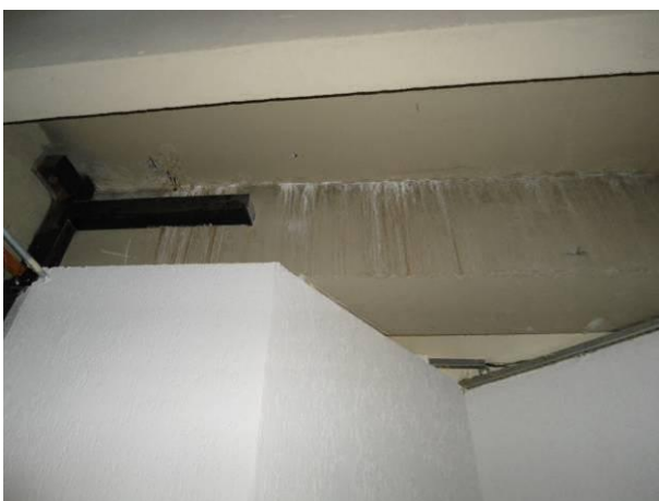
Foto 45 – Manchas escoamento de água com eflorescências na face lateral da Viga diagonal, no alinhamento do pilar P12.
