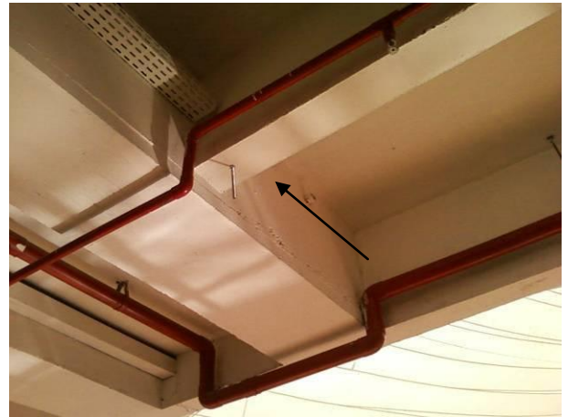
Foto 30 – Ponta de ferro na face inferior da Viga transversal entre os eixos 3/4 e C/D.
