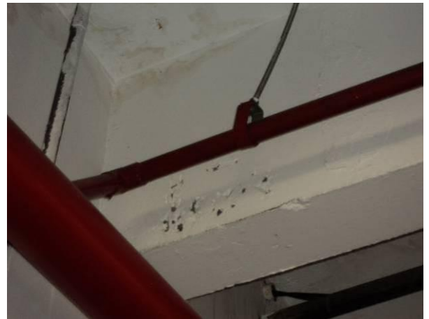
Foto 22 – Concreto segregado na face B da Viga transversal, junto ao pilar P2J entre os eixos 2/3.
