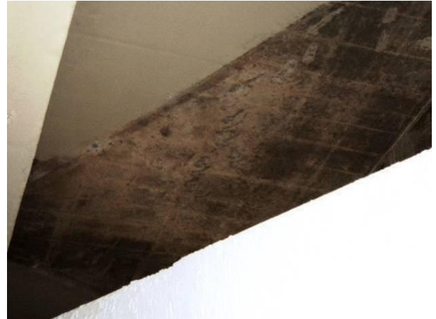
Foto 62 – Baixo cobrimento do concreto na armadura da laje, na região das vigas diagonais, entre os pilares P17 e P18.
