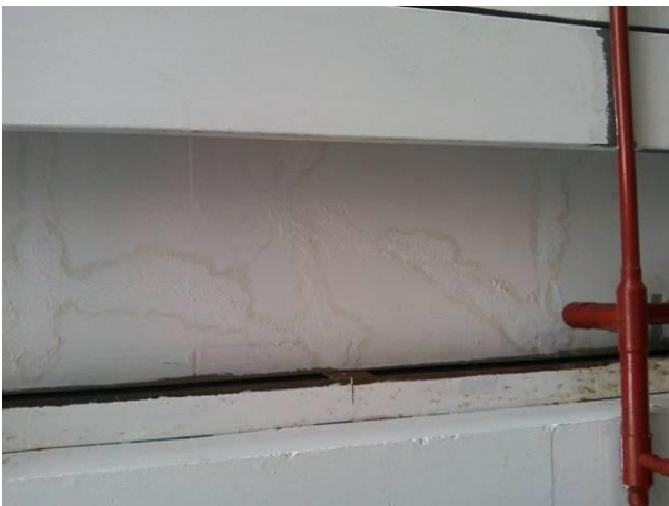
Foto 19 – Manchas de umidade na face inferior da Viga calha do eixo 2, entre eixos K/L.
