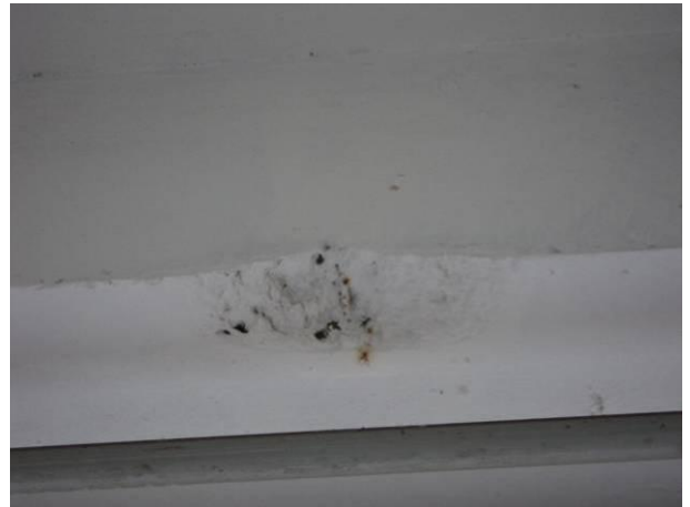
Foto 24 – Concreto disgregado com armadura exposta e corroída na face inferior da Viga transversal entre os eixos 4/5 e A/Borda.
