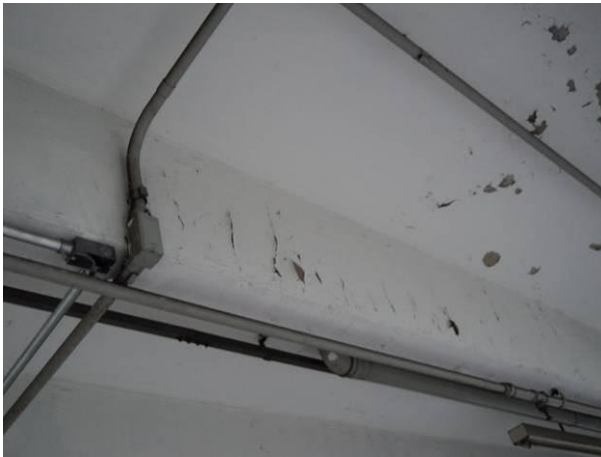
Foto 29 – Destacamento da pintura em pontos localizados da Viga transversal, face A, da entre os eixos 3/4 e A/Borda.
