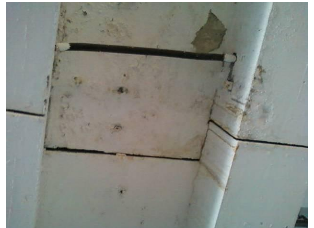
Foto 20 – Manchas de umidade na face inferior da Viga calha do eixo 3, na região da junta de dilatação, entre eixos B/C.
