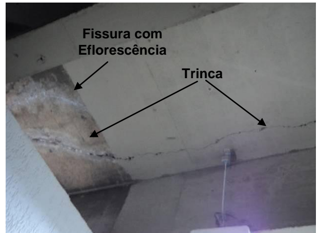
Foto 58 – Trincas e fissuras com eflorescências na face inferior da laje entre as vigas diagonais, entre os pilares P17 e P18.
