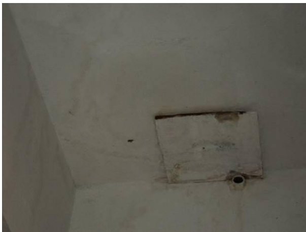
Foto 67 – Manchas de umidade e resto de forma na laje entre os eixos 1/2 e K/L, junto à viga longitudinal do eixo 3.
