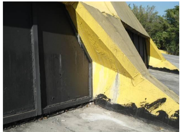
Foto 74 – Mancha de umidade na lateral da base da cúpula sobre o pilar P19.
