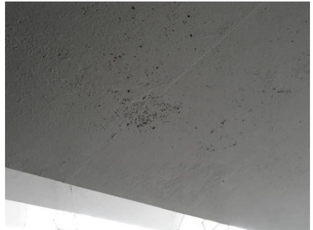
Foto 72 – Segregação superficial do concreto na face inferior da cúpula, na região entre os pilares P2 e P3.
