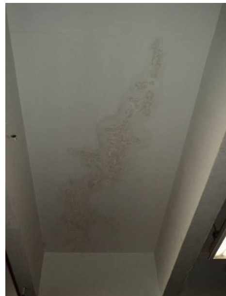
Foto 52 – Fissura com mancha de umidade na face inferior da laje entre os eixos 1/2 e I/J
