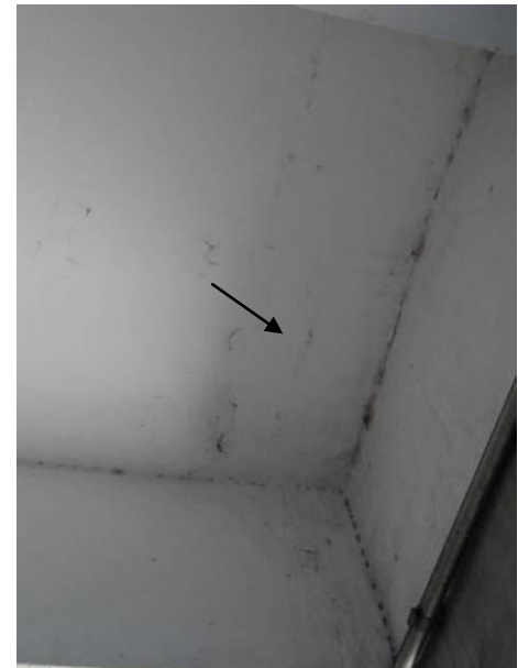
Foto 60 – Concreto disgregado com armadura exposta e corroída na laje, junto ao pilar P1B.
