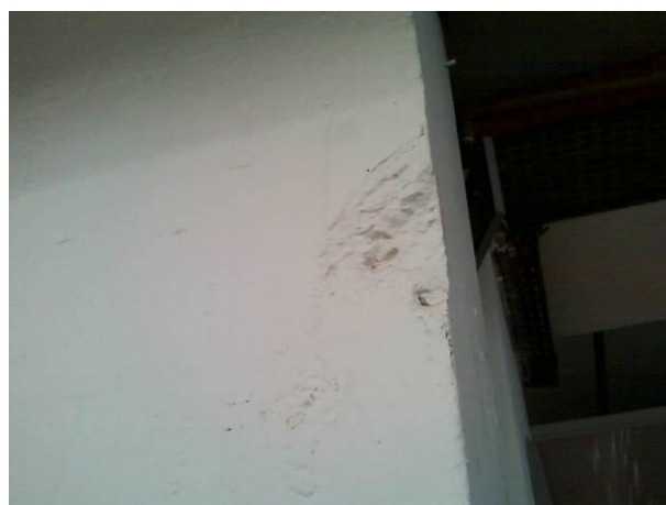
Foto 08 – Concreto disgregado na borda do pilar P3F – faces A/C.
