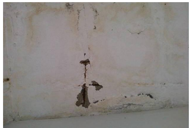
Foto 16 – Manchas de umidade, disgregação do concreto com armadura exposta e corroída na face inferior da Viga calha do eixo 5, entre eixo A/Borda.
