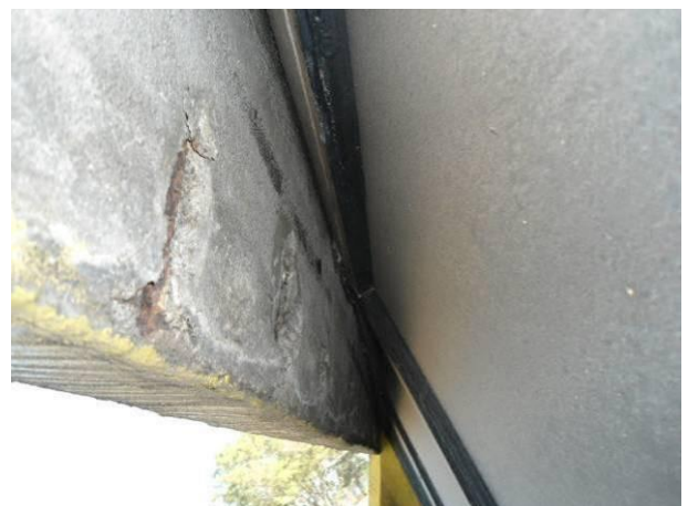
Foto 76 – Concreto disgregado com armadura exposta e corroída na borda interna da cúpula, entre os pilares P9 e P10.
