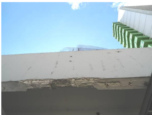
Foto 35 – Concreto disgregado com armadura exposta e corroída na face inferior e externa da Viga de borda do lado A, entre os eixos 7/8.
