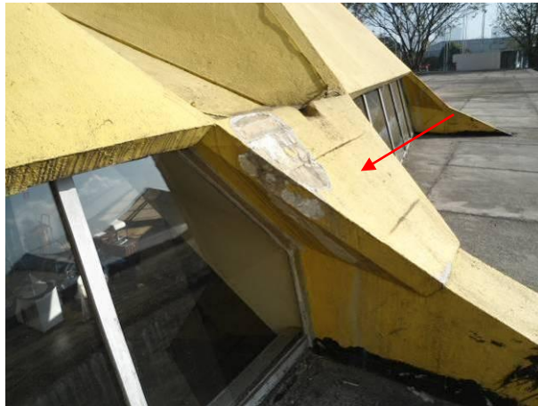
Foto 77 – Destacamento da pintura de proteção em pontos localizados da base da cúpula, sobre o pilar P1.
