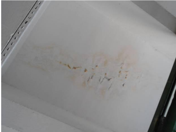
Foto 61 – Fissuras com manchas de umidade e princípio de disgregação do concreto por corrosão da armadura na face inferior da laje, entre os eixos 13/Borda e C/D.
