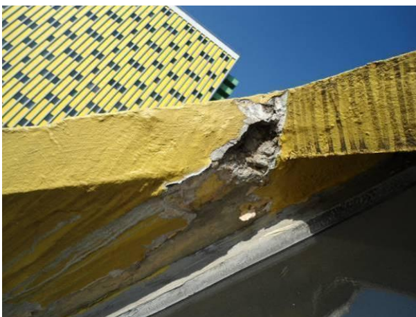
Foto 75 – Concreto disgregado com armadura exposta e corroída na borda da cúpula, na região sobre o pilar P28.
