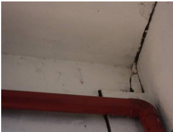
Foto 25 – Concreto disgregado na borda da Viga transversal, face A, entre os eixos 3/4 e C/D.
