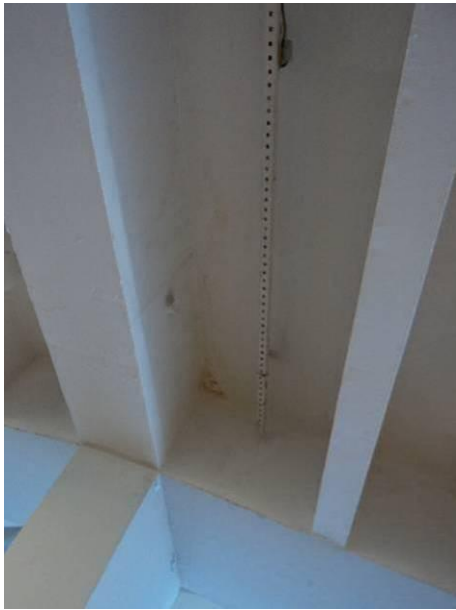
Foto 65 – Manchas de umidade na laje entre as vigas diagonais, próximo aos pilares P26 e P27.
