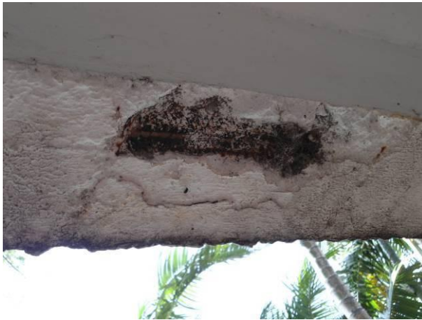
Foto 37 – Concreto disgregado com armadura exposta e corroída na face inferior da Viga de borda do lado D, entre os eixos 12/13.
