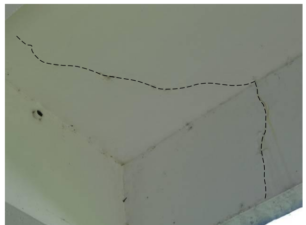
Foto 42 – Fissura com abertura de 0,2mm na Viga de borda do lado B, seguindo para a laje, entre os eixos 9/10.
