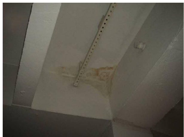
Foto 46 – Manchas de umidade na viga diagonal e na laje entre os pilares P7 e P8.
