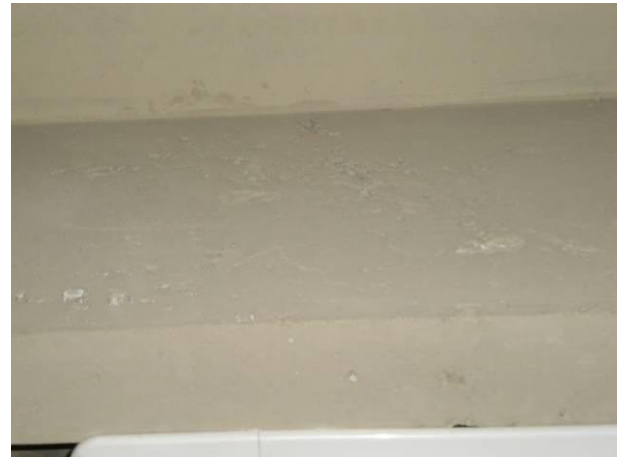
Foto 48 – Segregação superficial do concreto na face lateral da Viga diagonal entre os pilares P13 e P14.
