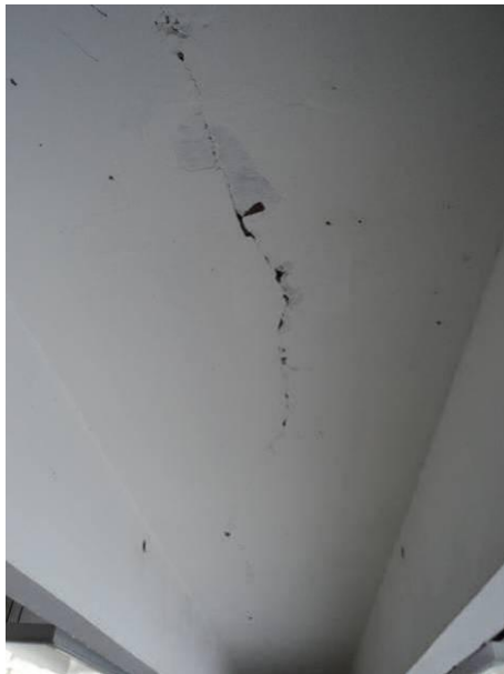
Foto 55 – Trinca longitudinal localizada ao longo de todo o trecho de laje, entre os eixos 1/2 e J/K.
