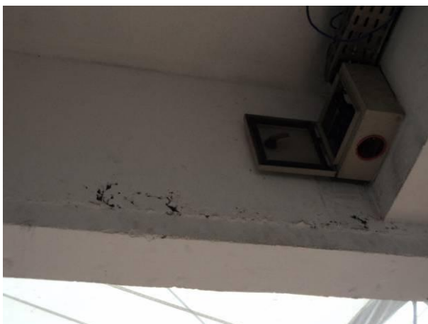
Foto 27 – Concreto segregado na face C da Viga transversal de borda do Hall 2 entre os eixos 4/5 e G/H.
