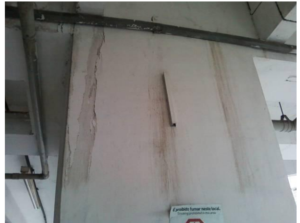
Foto 10 – Manchas de escoamento de água provenientes da junta de dilatação na face C do pilar P3A, localizado sob o Hotel Holiday Inn .
