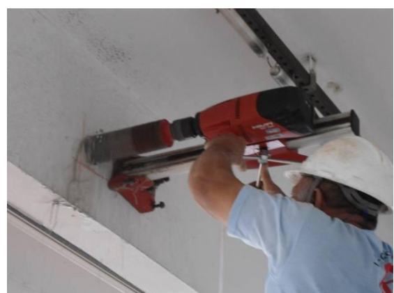
Foto 84 – Detalhe da extração do CP6 na viga entre os eixos 4/5 e L/Borda.
