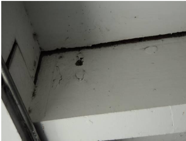
Foto 23 – Concreto disgregado com armadura exposta e corroída na face B da Viga transversal entre os eixos 1/2 e B/C.
