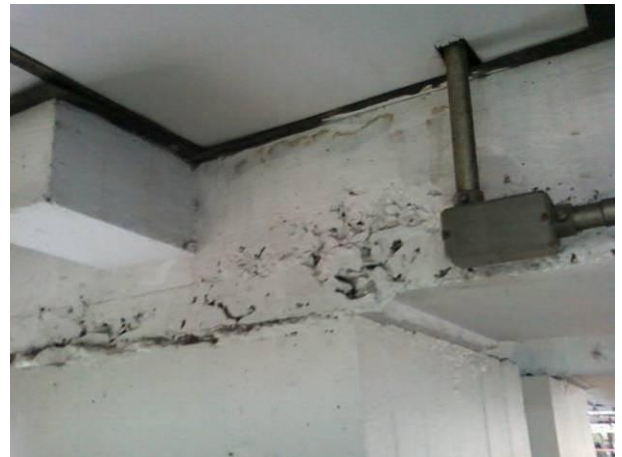
Foto 14 – Concreto segregado na face D da Viga calha do eixo 1, entre eixos D/E.
