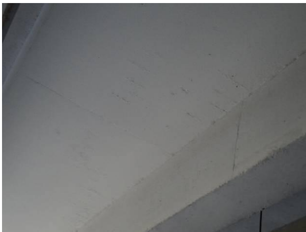
Foto 63 – Armadura exposta e oxidada originada do baixo cobrimento do concreto na laje entre os eixos 1/2 e A/B.
