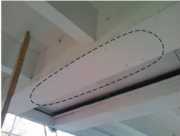
Foto 17 – Área com armadura exposta e corroída decorrente do baixo cobrimento do concreto, na face inferior da Viga calha do eixo 12, eixo L/Borda.
