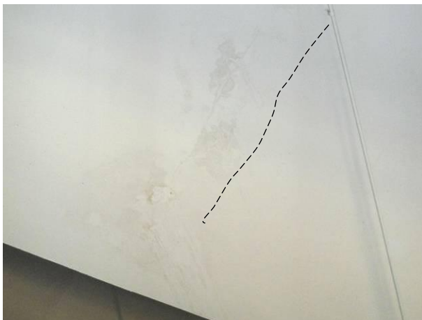
Foto 69 – Fissura com presença de umidade na face inferior da cúpula, na região entre os eixos dos pilares P22 e P23.
