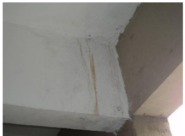
Foto 28 – Manchas de umidade na face A da Viga transversal sobre a rampa entre os eixos 1/2 e J/K.
