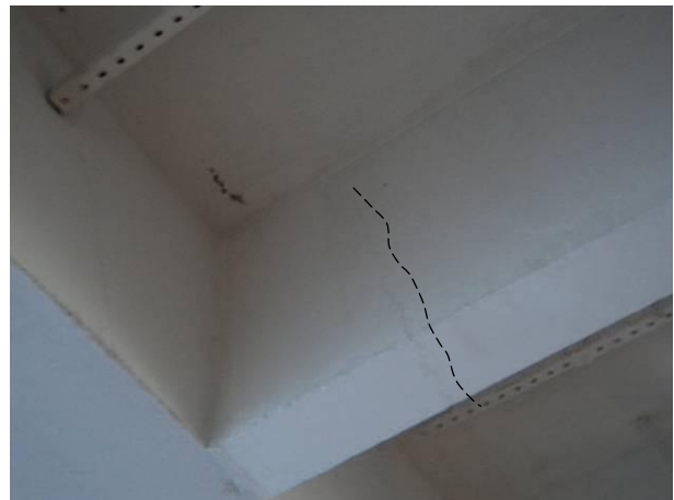
Foto 44 – Fissura vertical com abertura de 0,2mm nas faces da Viga diagonal entre os pilares P1 e P2.
