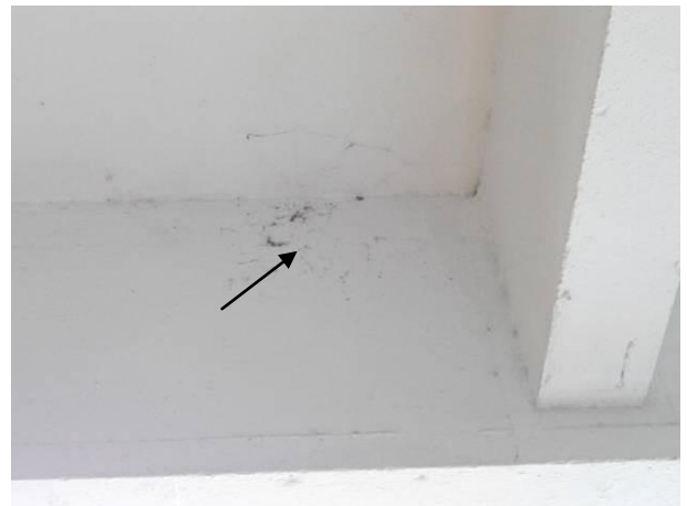
Foto 40 – Segregação superficial do concreto na face D da Viga de borda do lado C, entre os eixos D/E.
