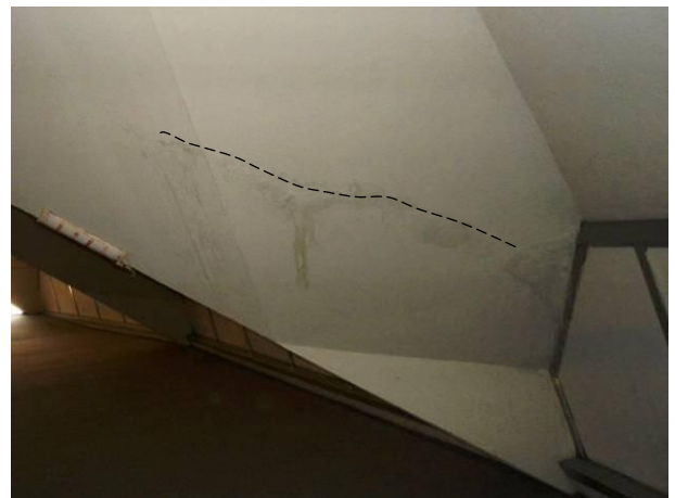
Foto 70 – Fissuras com eflorescência na face inferior da cúpula, na região entre os eixos dos pilares P8 e P9.
