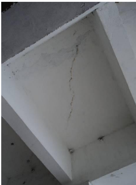
Foto 51 – Fissura diagonal com eflorescência na face inferior da laje entre os eixos 1/2 e L/Borda
