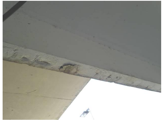
Foto 38 – Concreto disgregado com armadura exposta e corroída na face inferior da Viga de borda do lado A, entre os eixos 10/11.
