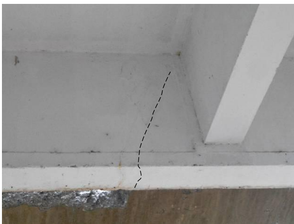
Foto 41 – Fissura com abertura de 0,2mm nas faces D e inferior da Viga de borda do lado C, entre os eixos J/K.
