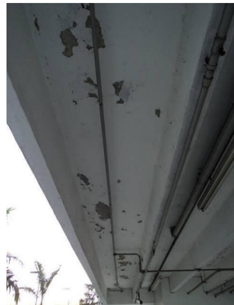
Foto 68 – Destacamento da pintura de proteção da superfície da laje, entre os eixos 2/3 e A/Borda.
