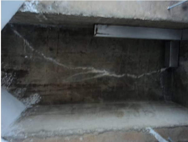
Foto 53 – Fissura com eflorescência na face inferior da laje, entre as vigas diagonais, entre os pilares P18 e P19.
