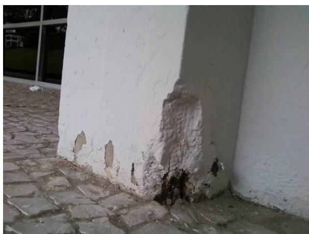
Foto 07 – Concreto disgregado com armadura exposta e corroída na base do pilar P11A – face A.
