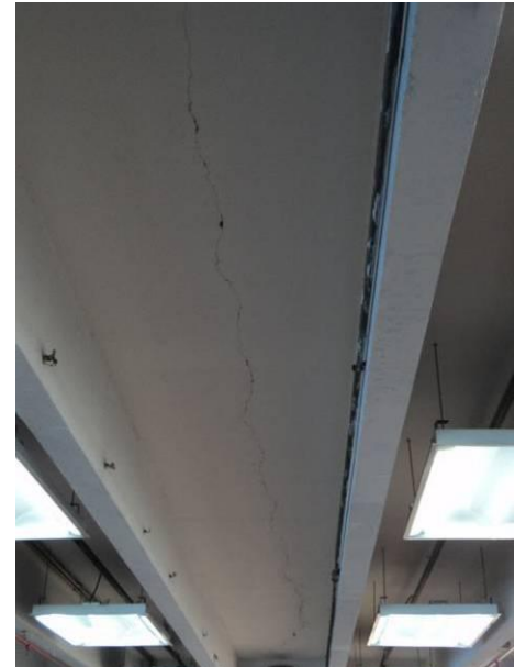
Foto 56 – Trinca longitudinal ao longo de todo o trecho de laje, entre os eixos 2/3 e C/D.
