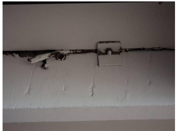
Foto 26 – Armadura exposta e corroída na face B da Viga transversal entre os eixos 2/3 e D/E.
