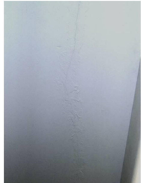
Foto 50 – Fissura longitudinal com abertura de 0,1mm na face inferior da laje entre os eixos 2/3 e J/K.
