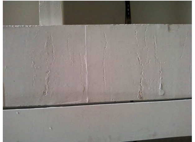
Foto 18 – Armadura exposta por baixo cobrimento na face inferior da Viga calha do eixo 2, entre eixos J/K.
