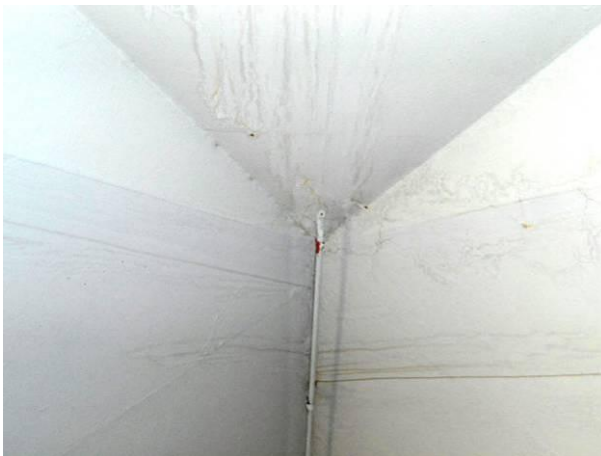
Foto 73 – Mancha de umidade na face inferior da cúpula, entre os pilares P23 e P24.
