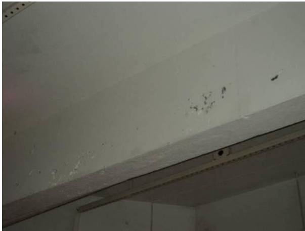
Foto 47 – Concreto segregado na face lateral da Viga diagonal entre os pilares P11 e P12.
