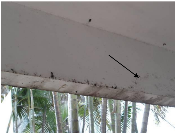
Foto 39 – Segregação superficial do concreto na face A da Viga de borda do lado B, entre os eixos 12/13.
