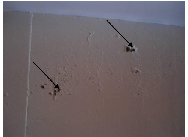
Foto 78 – Área com segregação superficial do concreto com presença de armadura exposta e corroída na face inferior da laje do mezanino (cadeiras superiores).
