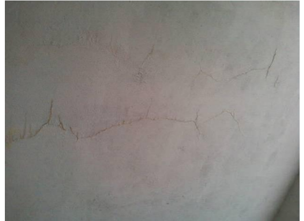
Foto 54 - Fissuras com eflorescência na face inferior da laje da rampa de acesso à laje do Palácio.
